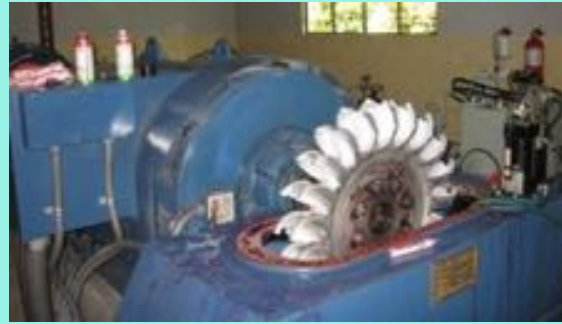
Pequeñas Centrales Hidroeléctricas
